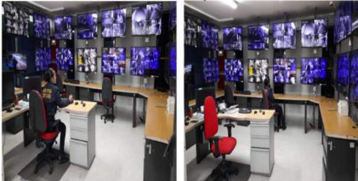
Ilustración 13. Central de monitoreo y control de cámaras SDH
