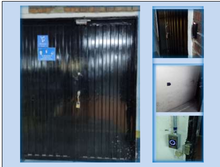
Imagen No. 5. Sistema de control de acceso área de Almacén y Bodega Entrada principal - Tarjeta de aproximación
