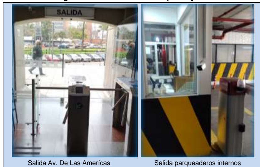
Imagen No. 11. Sistema de talanqueras y cámaras
